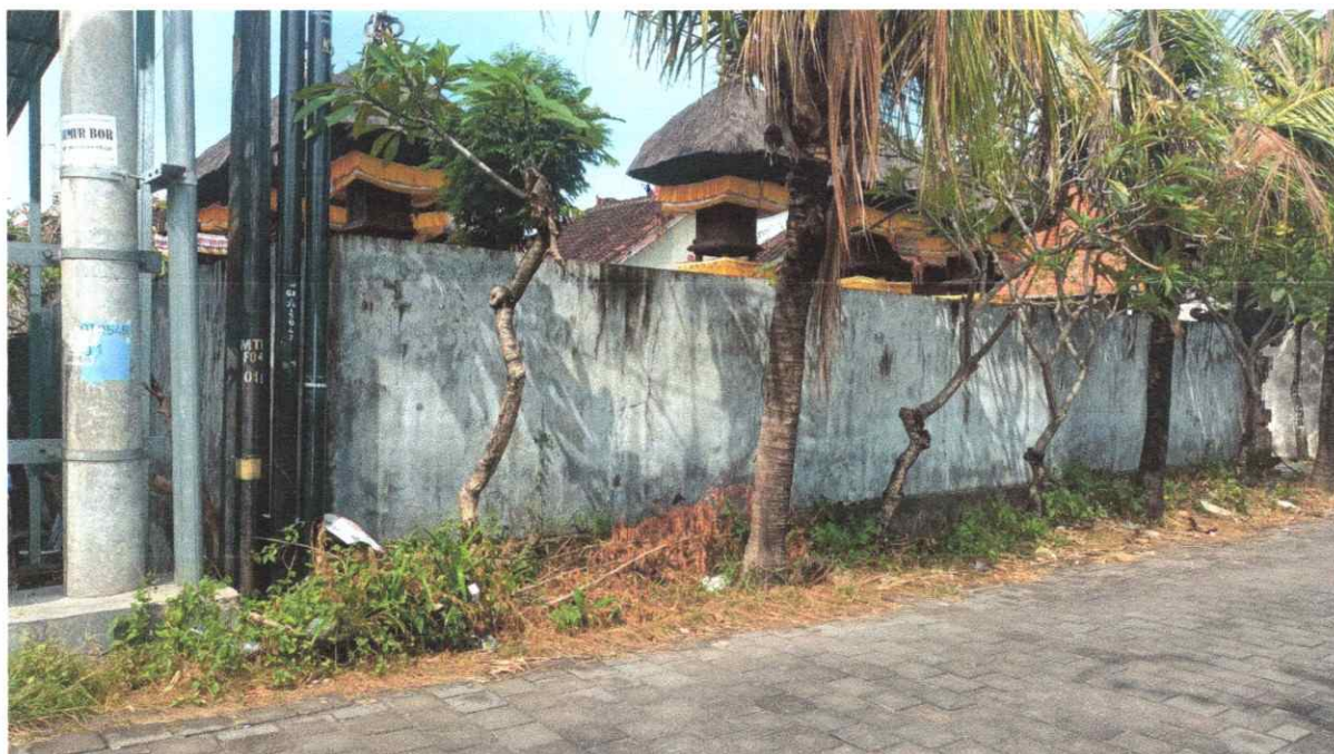
Penyengker sisi utara bagian luar yang diajukan perbaikan dengan luas 20,57 M 2
