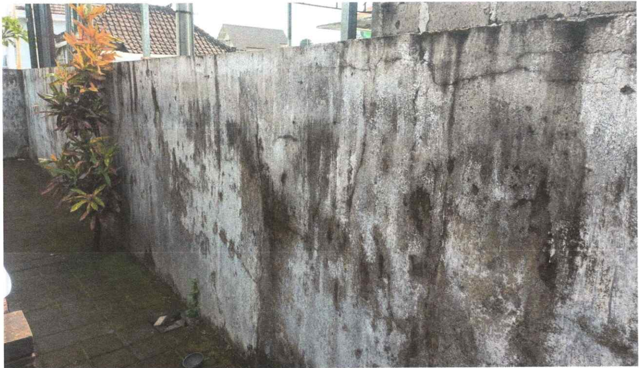
Penyengker sisi timur bagian dalam yang diajukan perbaikan
