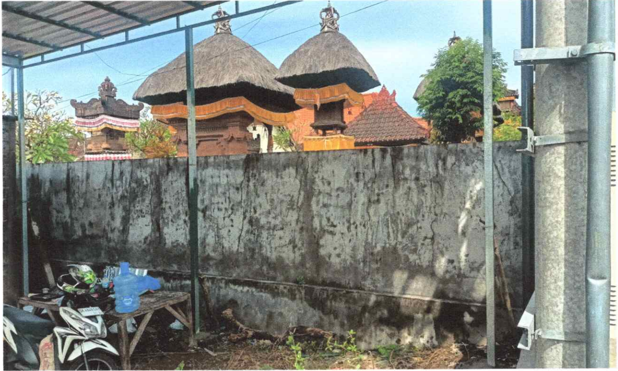
Penyengker sisi timur bagian luar yang diajukan perbaikan dengan luas 18,53 M 2
