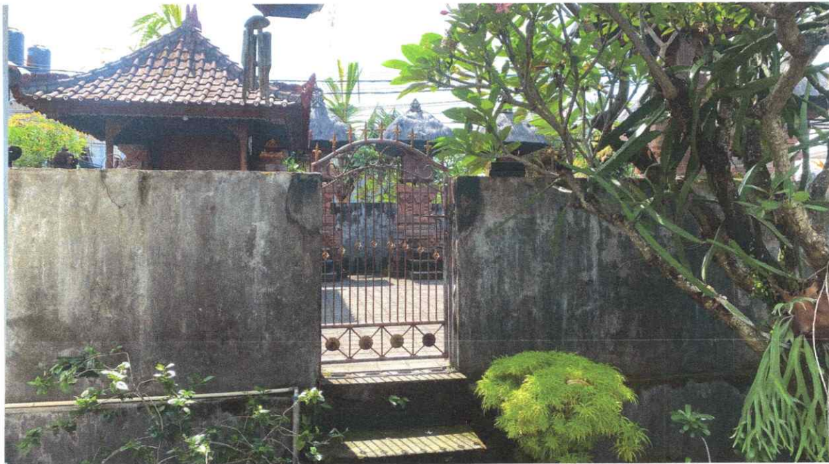
Penyengker sisi selatan bagian luar yang diajukan perbaikan
