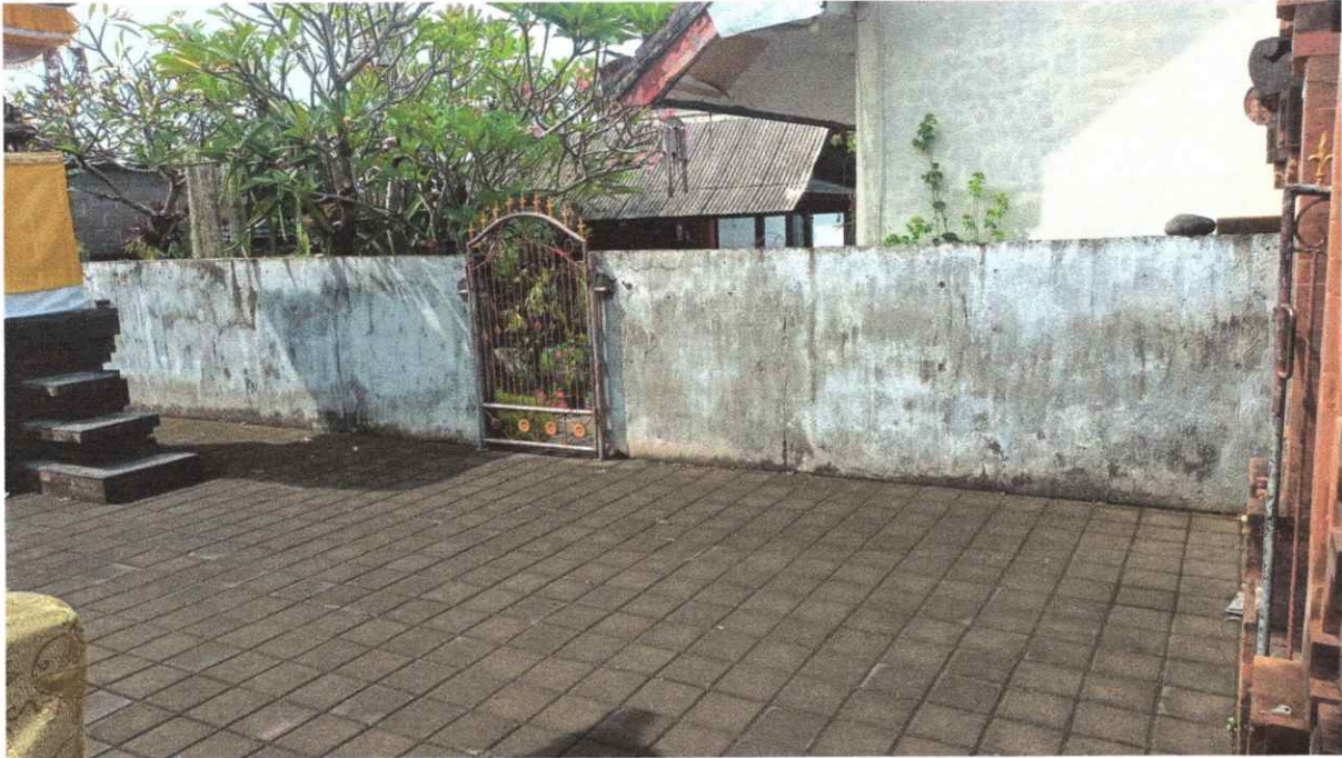
Penyengker sisi selatan bagian dalam yang diajukan perbaikan dengan luas 13,81 M 2
