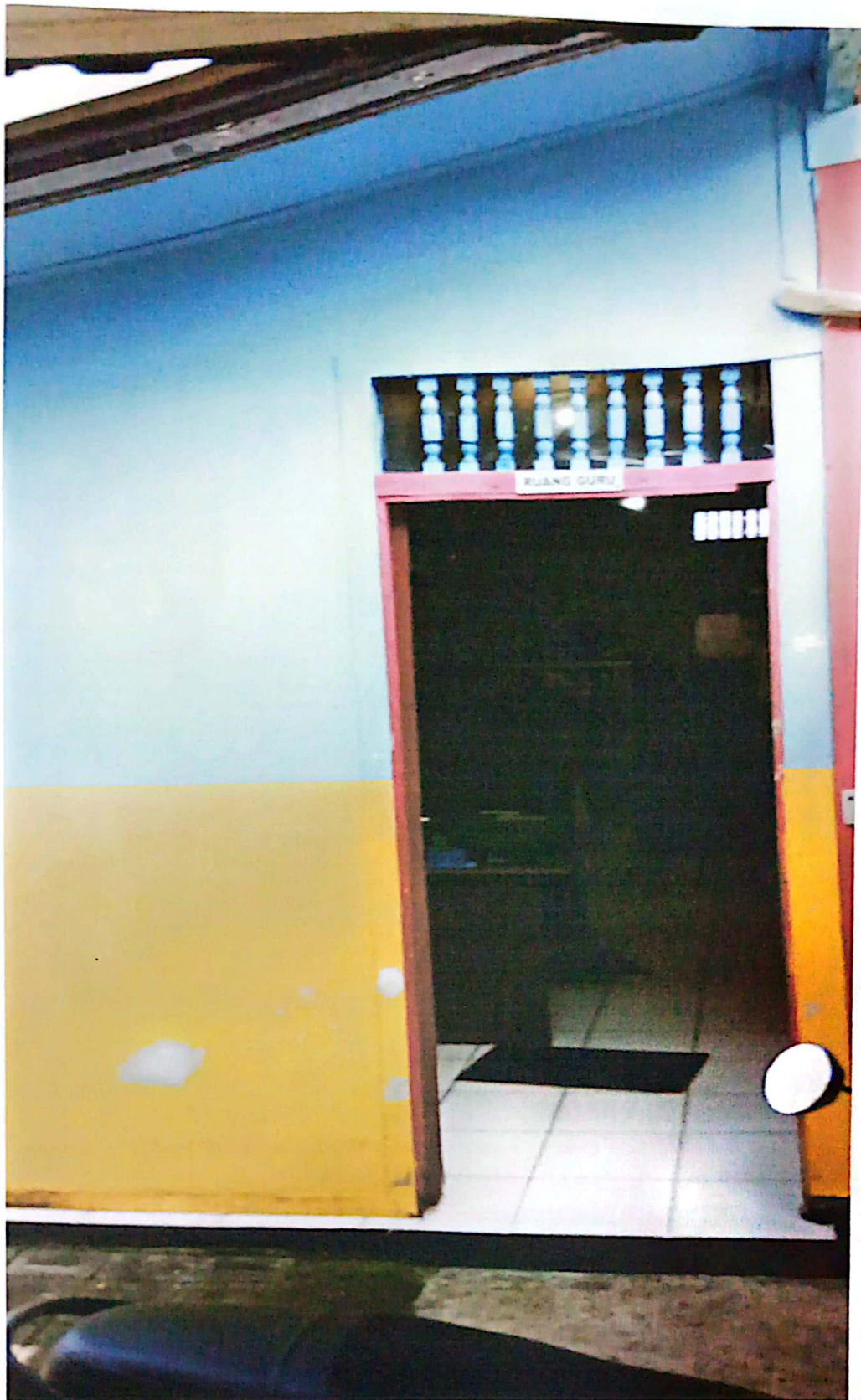
KONDISI BANGUNAN RUANG GURU SEKOLAH PAUD PANDU KUMARA YANG TERBUAT DARI GIBSUM SEBELUM MENDAPAT PERBAIKAN
