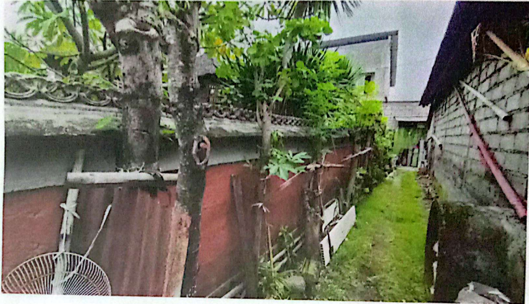
Penyengker sisi utara bagian luar yang diajukan perbaikan
