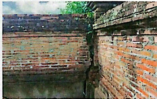
Kondisi Tembok Penyengker
