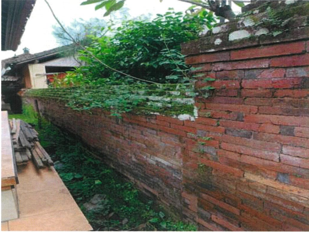
FOTO TEMBOK PENYENGER SANGGAH SIRA ARYA BELOG (yang akan diperbaiki)
