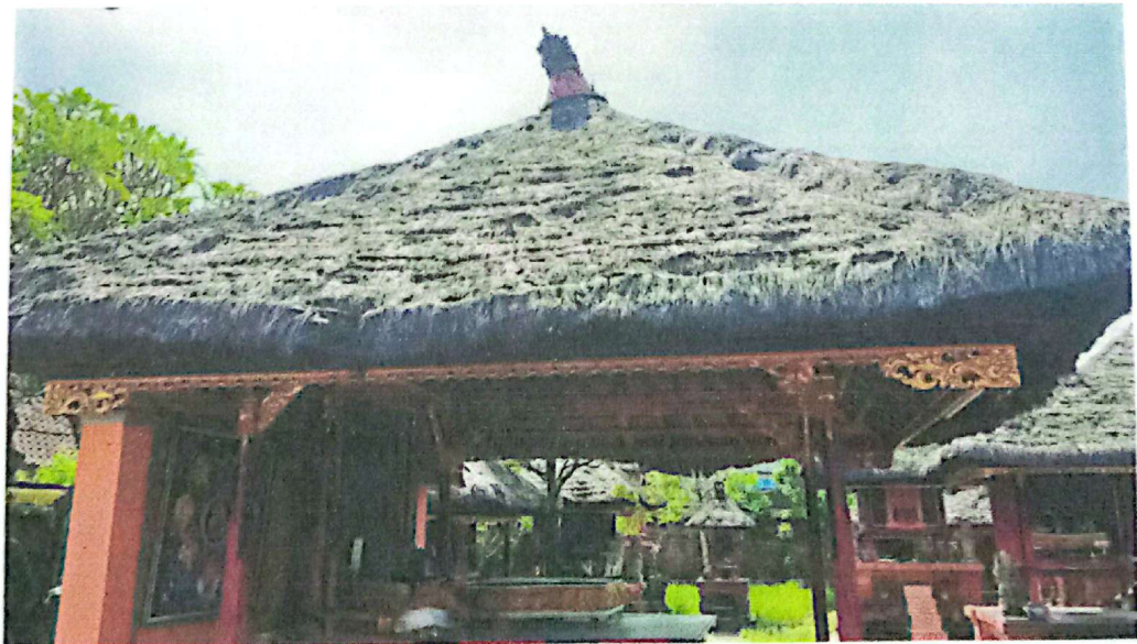
Gambar 01. Kondisi Atap saat ini yang hampir ambruk
