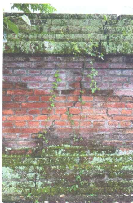
Tembok sepanjang 69 meter retak, sudah termakan usia, tidak layak, dan berpotensi membahayakan
