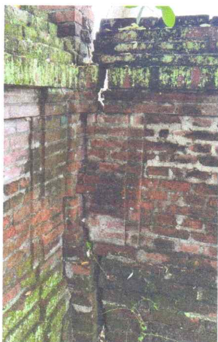
Tembok sepanjang 69 meter retak, sudah termakan usia, tidak layak, dan berpotensi membahayakan
