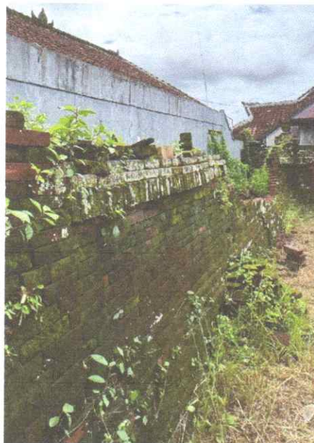
Tembok sepanjang 11 meter roboh, sudah tidak layak, dan berpotensi membahayakan.
