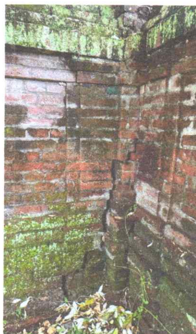
Tembok sepanjang 69 meter retak, sudah termakan usia, tidak layak, dan berpotensi membahayakan
