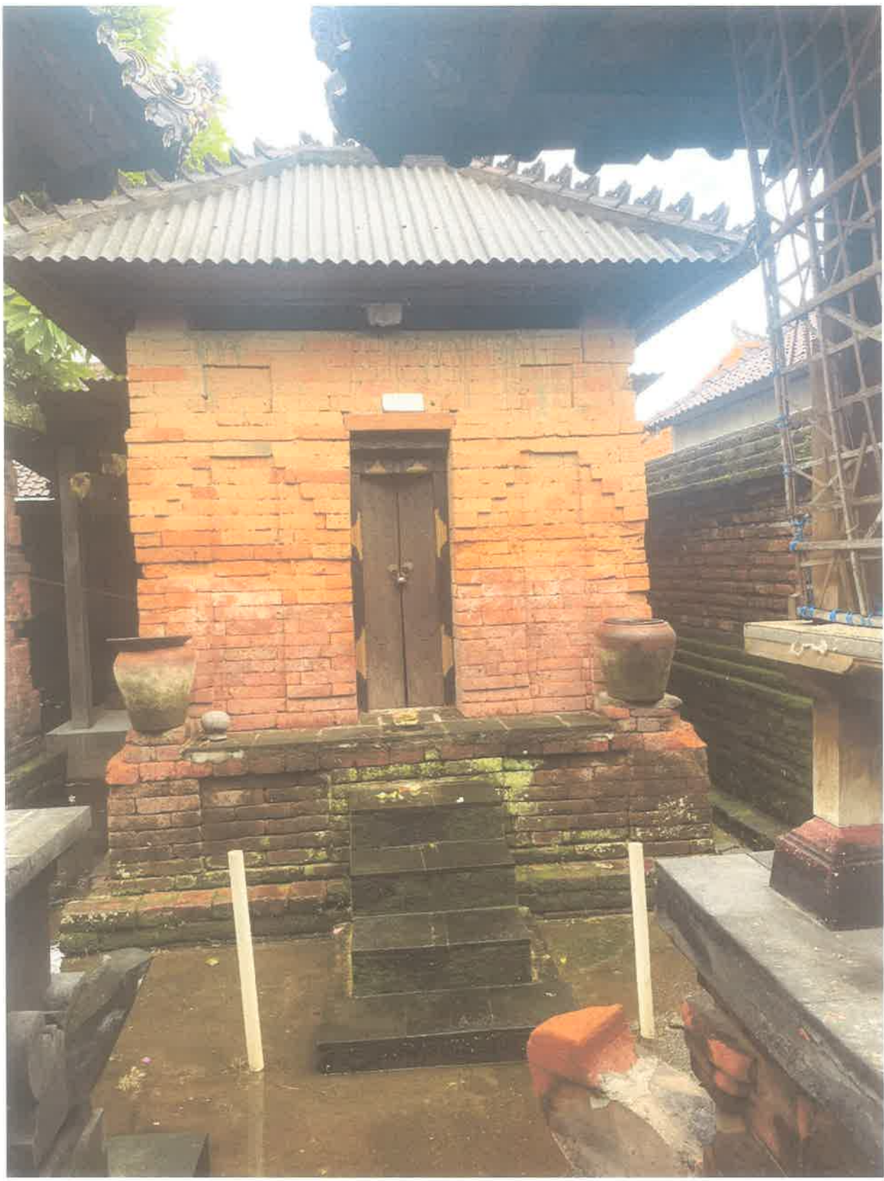
Foto Gedong IBU Yang Akan di Perbaiki
