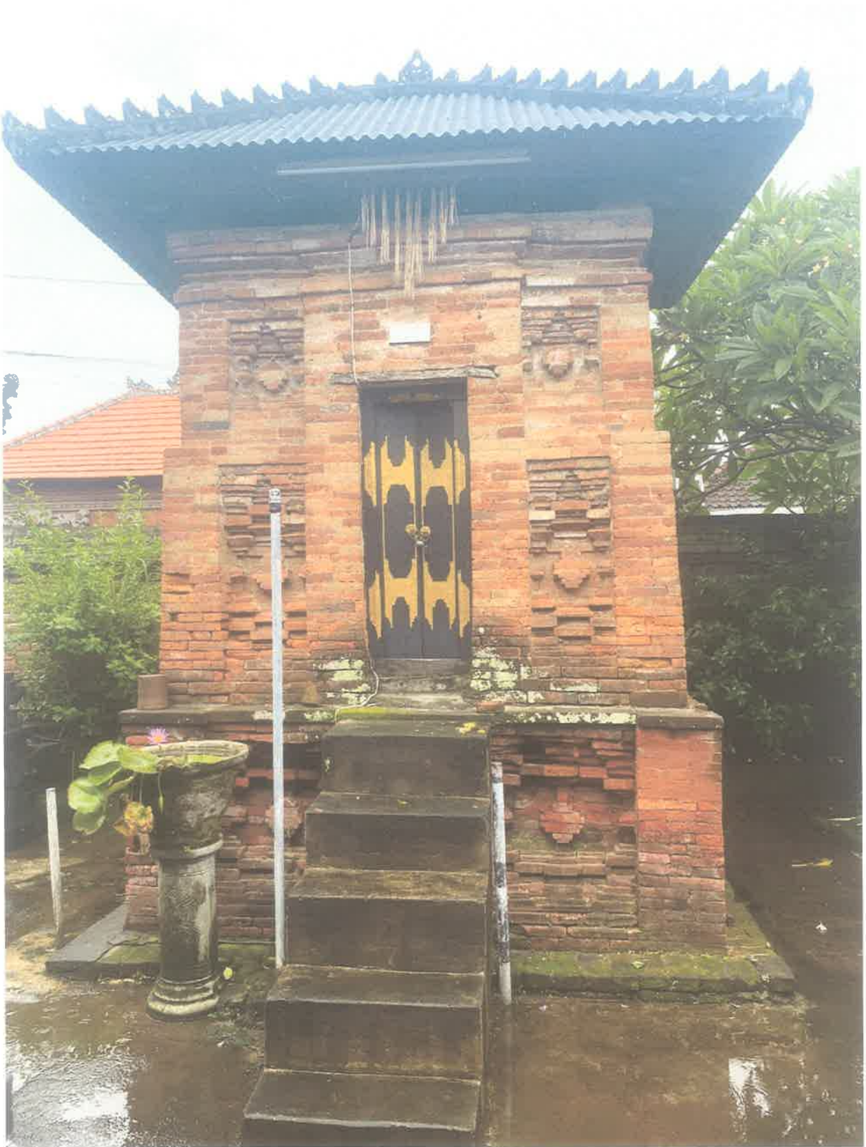
Foto Gedong Pemayun Yang Akan di Perbaiki
