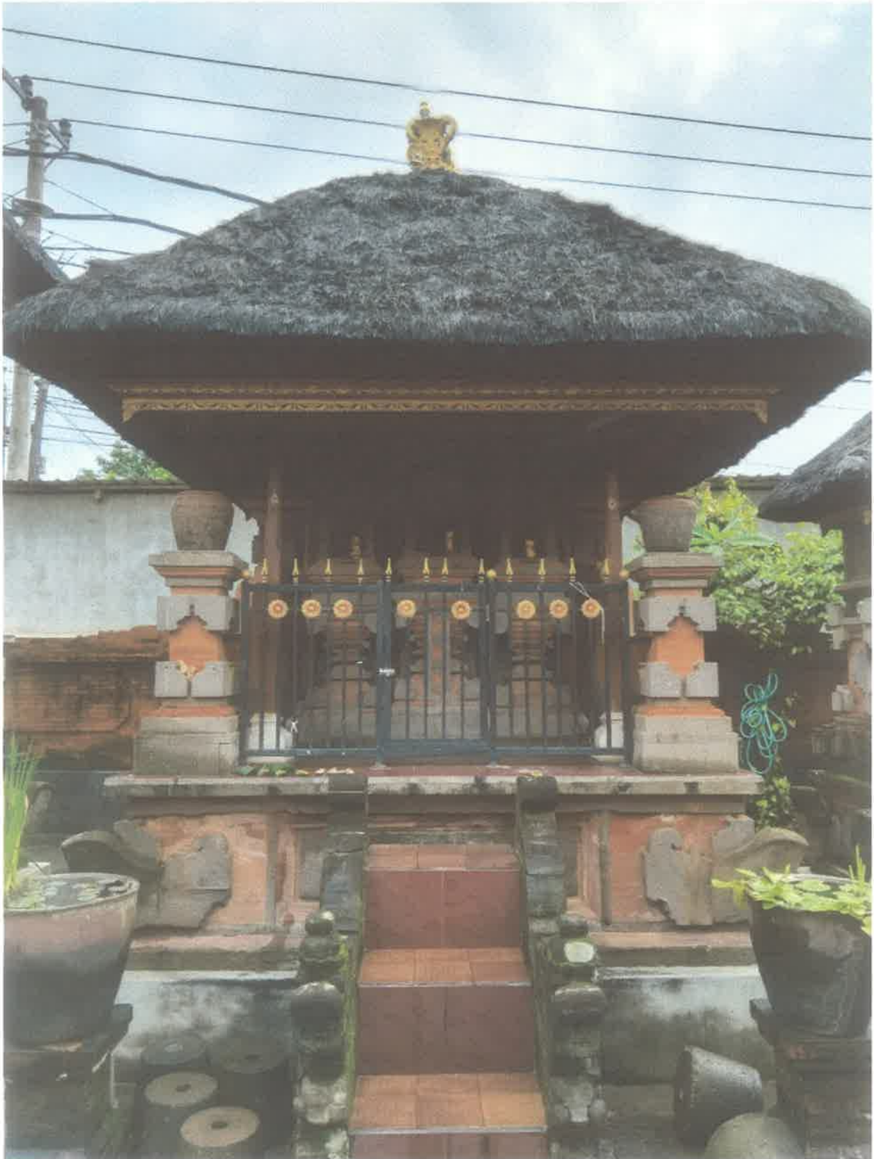
FOTO PELINGGIH PERTIWI YANG AKAN DIPERBAIKI
